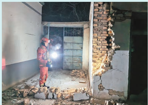
◆23日凌晨，救援人員在烏什縣亞曼蘇柯爾克孜族鄉檢查房屋受損情況。
