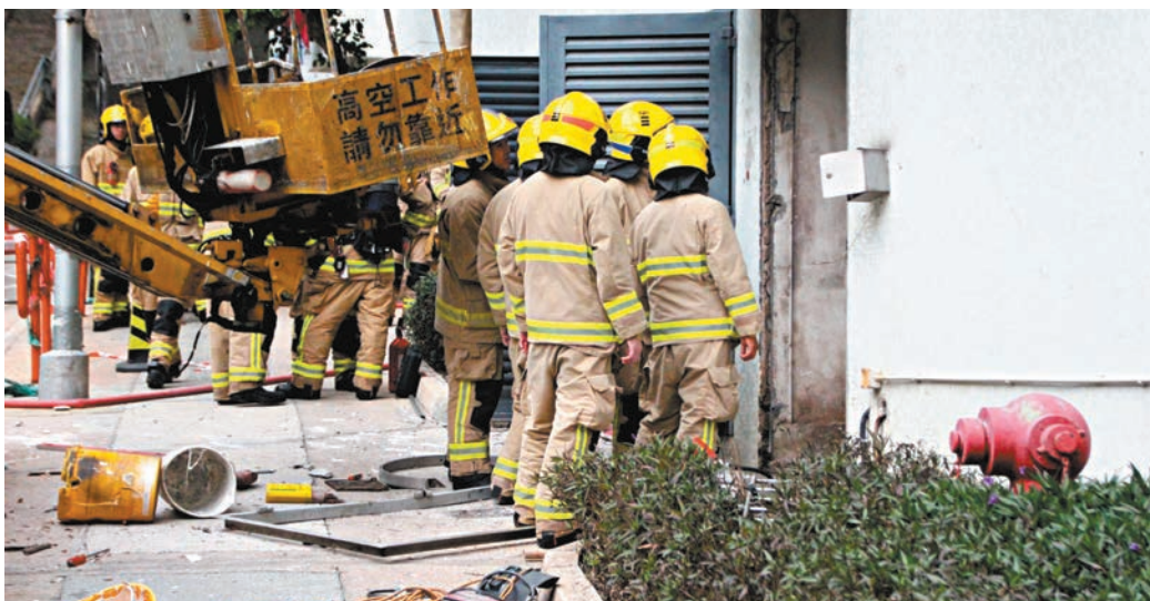
◆兩名男工人在電錶房外安裝鐵梯，未料突然發生猛烈爆炸。
