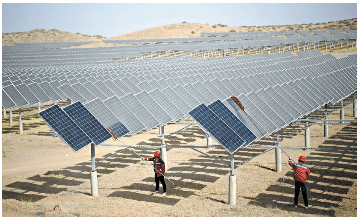
◆ 習近平指出，牢固樹立和踐行綠水青山就是金山銀山的理念，堅定不移走生態優先、綠色發展之路。圖為早前工作人員在銀川市第四光伏電站對光伏板進行除塵作業。 資料圖片
