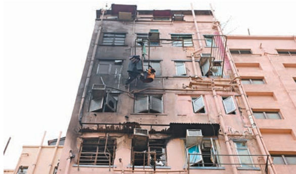
◆起火單位嚴重焚毀，樓上多層單位外牆熏黑。
