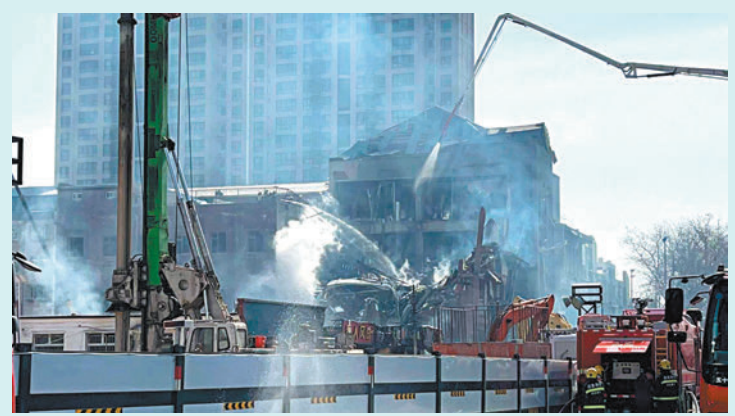
消防員正在撲滅餘火。
