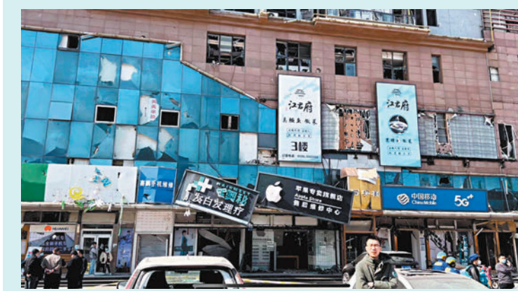
爆炸現場對面商業街的建築窗戶被震壞。
