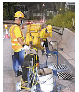
◆承建商人員於演練前利用閉路電視檢查集水溝內的情況。
