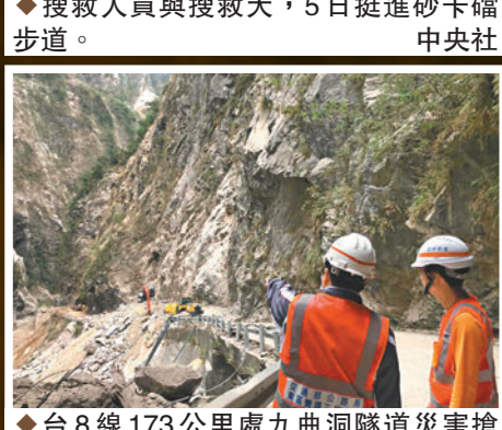
◆台8線173公里處九曲洞隧道災害搶修情形。 中央社
