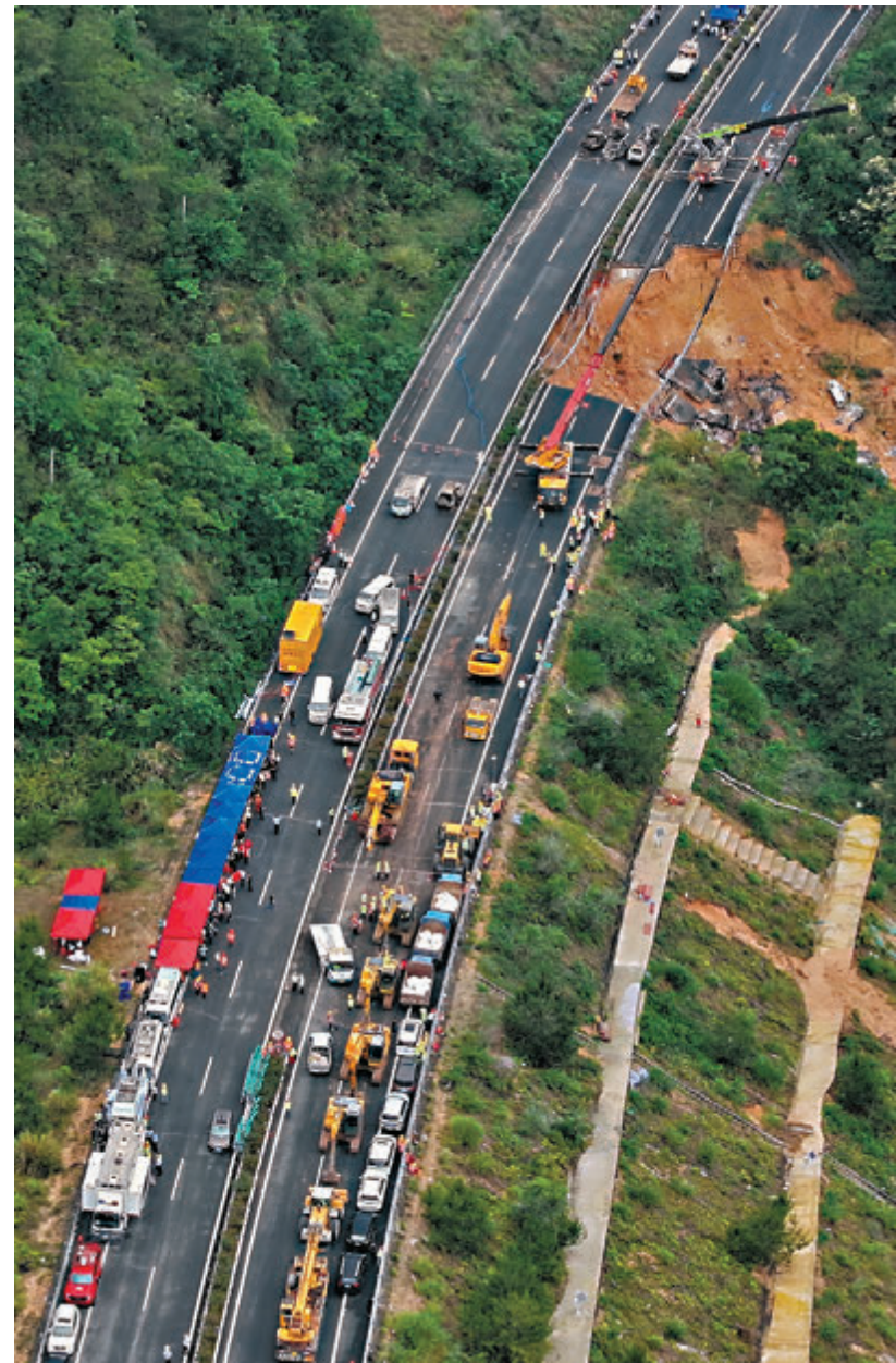
◆5月1日梅大高速茶陽路段發生一處路面塌方事故後，廣東省委省政府高度重視，省、市全力開展救援工作，成立事故救援現場指揮部，公安、應急、消防、衛健、交通、礦山救護隊等投入500多人參與現場救援。
