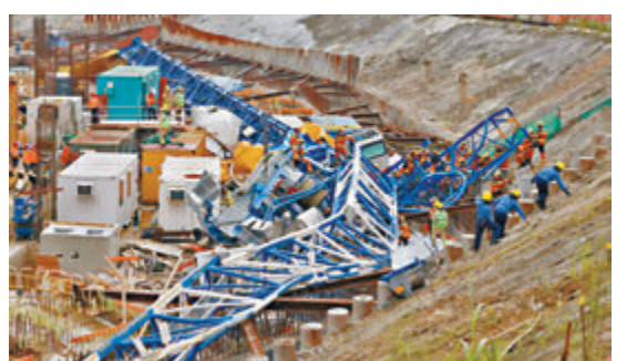
◆當日安達臣道房協地盤塌天秤事故釀3死6傷慘劇。資料圖片
