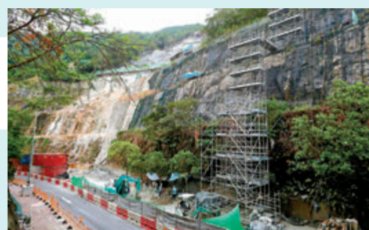
◆耀東邨塌山泥的斜坡加固工程至今未竣工，居民出行多有不便。香港文匯報記者郭木又攝
