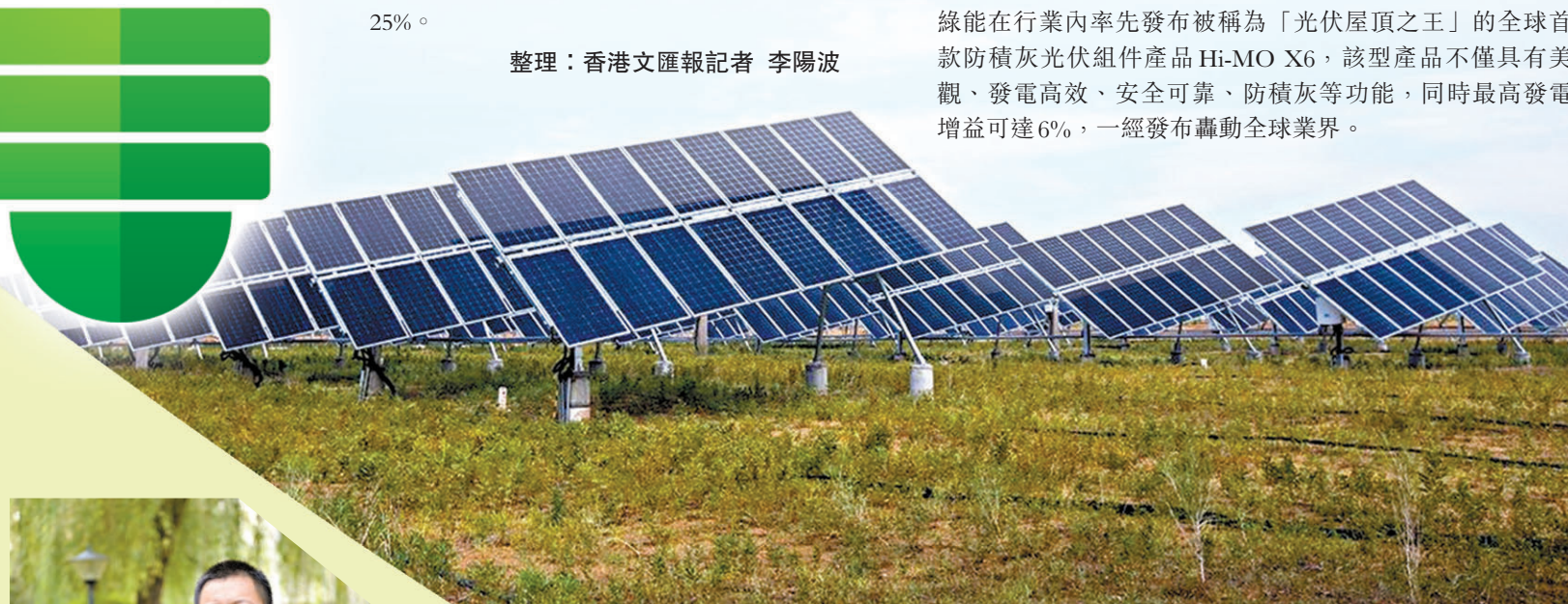
◆在中國西部連綿起伏的沙地上，整整齊齊排列着藍色的光伏板，形成了大片大片的「藍海」。香港文匯報陝西傳真
