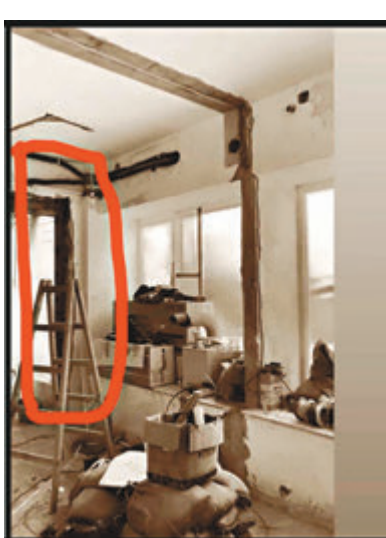
◆涉事單位的裝修工程中，分隔睡房的主力牆被「打穿」。資料圖片
