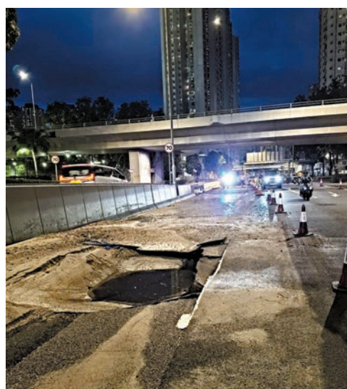
◆黃竹坑爆水管，路面現大洞。 區議員張偉楠Fb圖片
