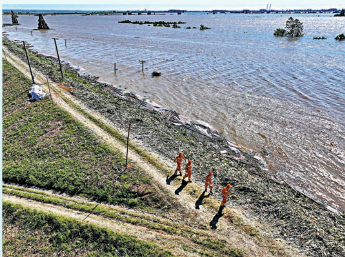
◆7月7日，搶險人員在錢團閘堤巡堤查險，全力守住「第二道防線」。 新華社
