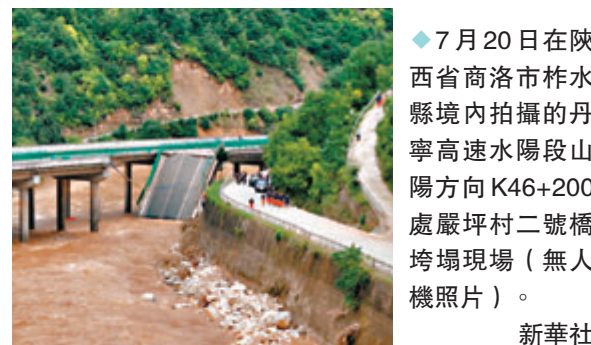
◆7月20日在陝西省商洛市柞水縣境內拍攝的丹寧高速水陽段山陽方向K46+200處嚴坪村二號橋垮塌現場（無人機照片）。新華社
