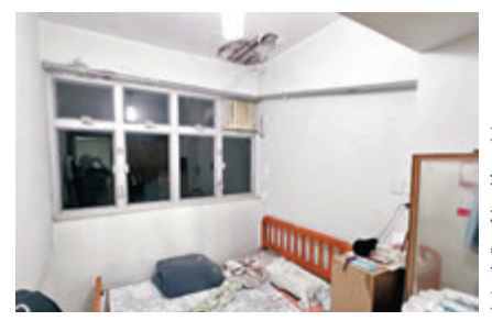
◆墜下的天花石屎落在老翁的床頭枕邊，天花露出生鏽鋼筋。結構沒有明顯危險，但為安全起見，已要求單位佔用人暫時不要進入受影響的範圍，直至完成所需的維修工程。並會繼續跟進有關個案的維修情況，以確保單位佔用人安全。資料顯示，涉事美新大廈於1964年5月入伙，提供131個單位，樓齡已達60年。
