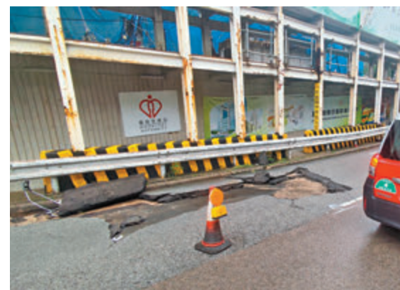
◆部分路段出現路陷。
