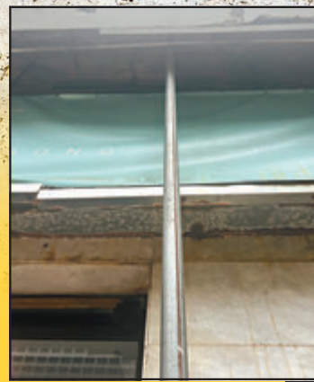
▲為防止石屎脫落，大廈地面已安裝不少支撐柱。
