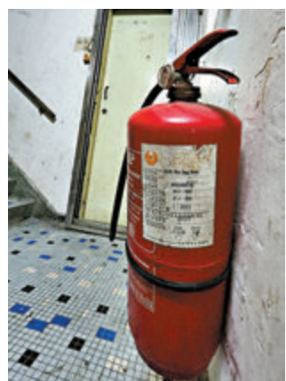
◆吳松街三無大廈縱有滅火筒，但上次檢查日期已是9年前。
