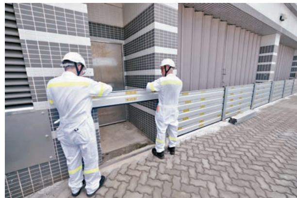
▶可拆除式防洪閘保護南丫發電廠內重要關鍵發電設施及相關輔助設施。 香港文匯報記者涂穴 攝
