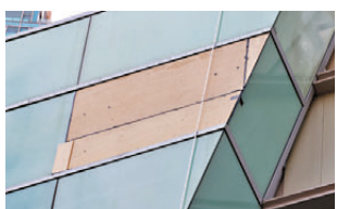
●幕牆玻璃破裂位置已被木板暫時圍封。
