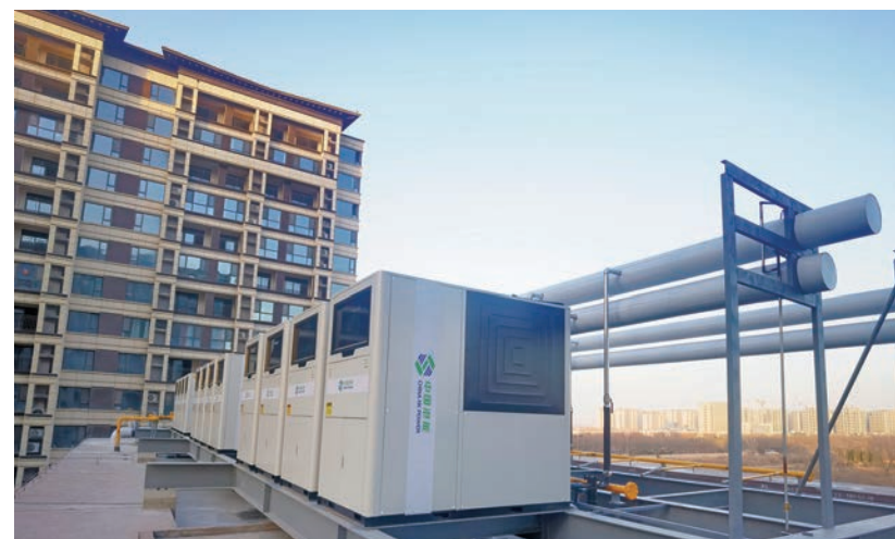
圖註：西安城市智慧供熱項目。
