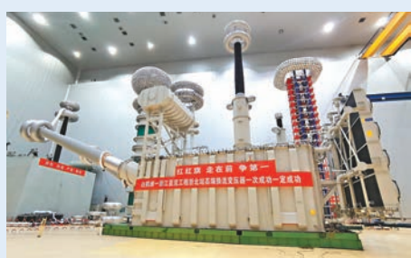
●國內自主研发的±800千伏換流變壓器 受訪者供圖
