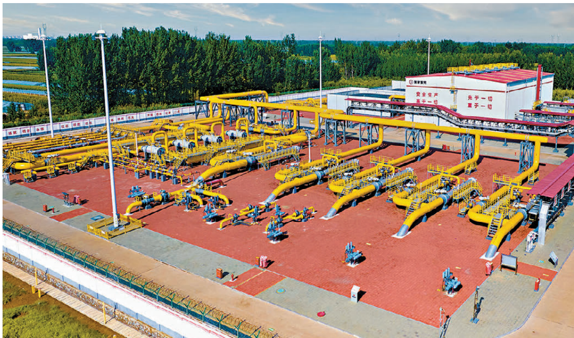
●中俄東線天然氣管道工程2日正式全線貫通，年輸氣能力增至380億立方米。圖為中俄東線天然氣管道永清站。
