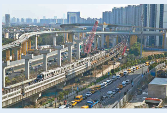
●22日上海地鐵11號線遭吊車侵入事故,應急管理部已派出工作組趕赴現場。
