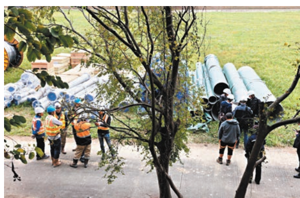
●上水圍文閣村附近一工地昨日發生男雜工遭鋼管擊中昏迷，送院不治。香港文匯報記者鄧偉明攝
