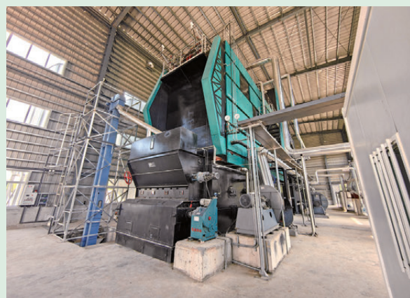
●中裕能源生物質供能項目。
