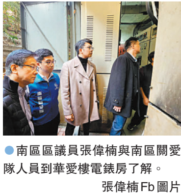
●南區區議員張偉楠與南區關愛隊人員到華愛樓電錶房了解。張偉楠Fb圖片
