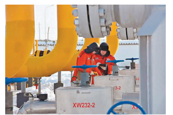
1月16日，工作人員在塔里木油田西氣東輸第一站巡檢。
