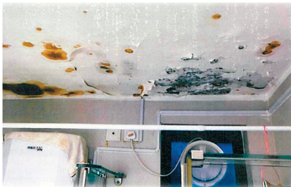
●青衣居民張小姐樓上滲水多年，求助無門。
