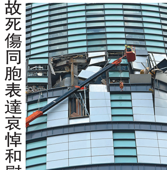
●台中新光三越百貨13日發生氣爆，建築物外牆嚴重毀損，工程人員14日進場清除可能掉落物。中央社
