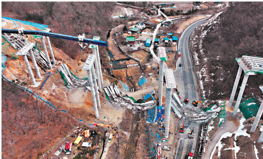
● 巨大橋板從約50米高處垮塌，造成10名工人傷亡。 法新社
