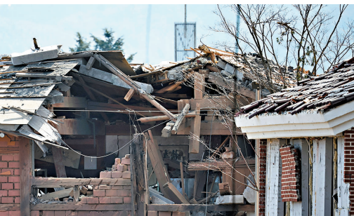
●當地一些房屋嚴重受損，玻璃窗碎裂，旁邊地面上散落瓦礫。
