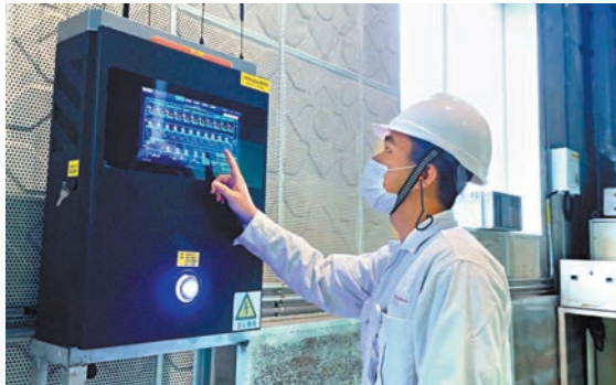
●工業 AI 應用在汽車行業中，有效提升公輔系統能效水平。香港文匯報廣州傳真
