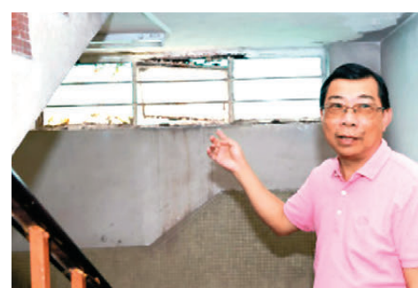
●癩癩樓業主方先生指，大廈部分公用地方的天花和牆身石屎剝落，且鋼筋外露，即將做大維修，相信物管公司能發揮協助業主的職能。
