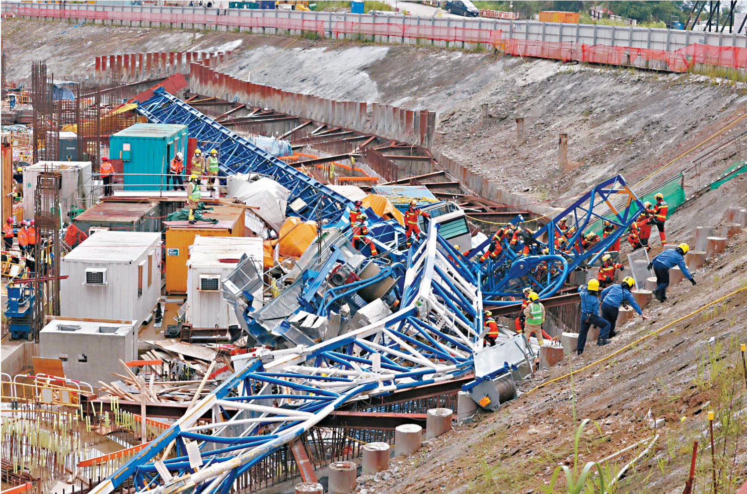
●2022年9月安達臣道地盤天秤倒塌，造成3死6傷。 資料圖片
