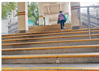
●田灣邨樓梯警示線長期失修，不少街坊在上下樓梯時均小心翼翼以防滑倒。 香港文匯報記者張茗 攝
