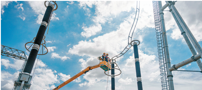
●2日，南方電網廣東電網公司工作人員對相關線路開展展排查，確保迎峰度夏期間電網設備安全可靠運行。中新社
