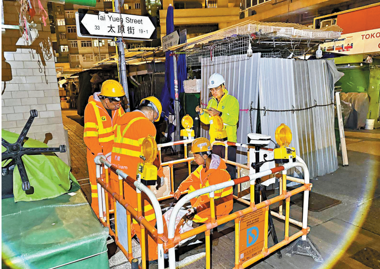
●渠務署早在前晚（9日）已經開始通渠作業。 渠務署Fb圖片
