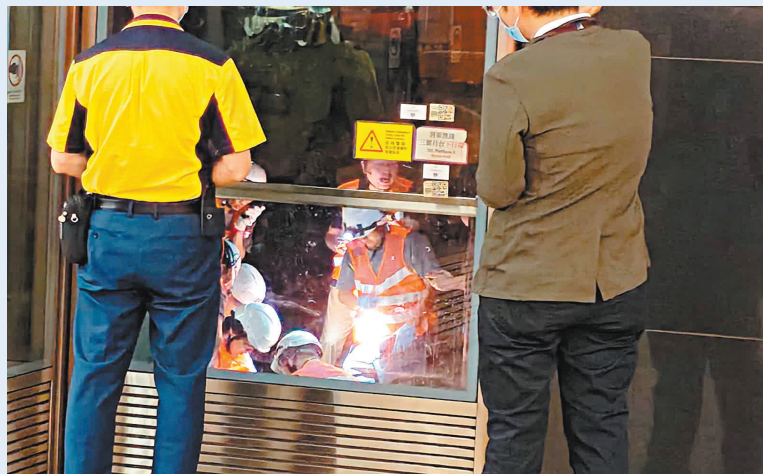
●港鐵北角站昨日有信號設備運作不暢順，人員進行搶修。
