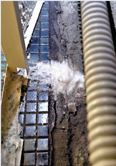
●黃女士家中漏水嚴重，只要樓上住戶用水，家裏就漏得厲害，甚至頭上都會被滴水。 大公文匯全媒體記者蘇鉅祖 攝
