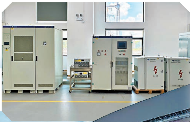
▶廣州供電局的系列電能質量治理裝置。
