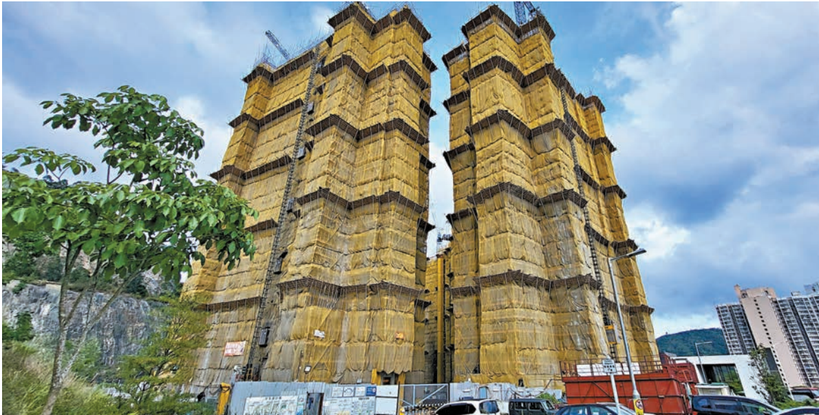
●長實位於觀塘安達臣道的港人「首置盤」工程有部分結構的鋼筋未有依照《建築物條例》標準安裝一事，署方合共提出205項檢控。
