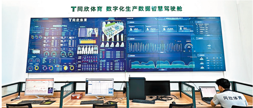
●數字化生產數據智慧駕駛艙，集成了同欣生產基地所有生產線相關數據。
