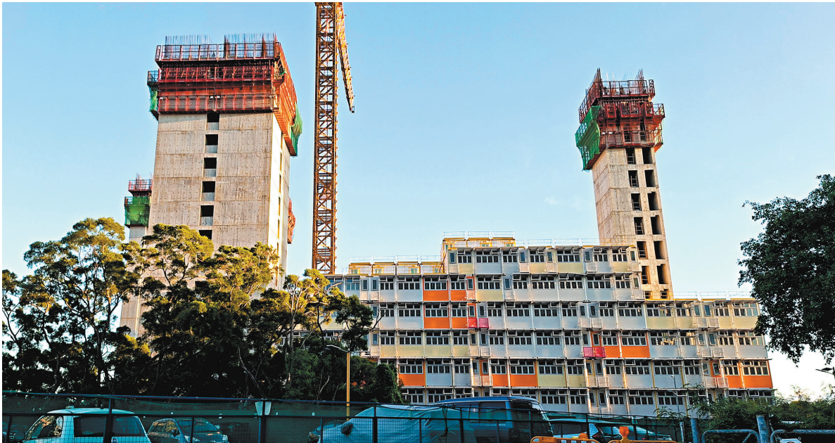
●建築署於恒常巡查中發現，小欖簡約公屋用作固定預製單位與石屎牆之間的螺絲被人剪短。圖為該簡約公屋建築地盤。香港文匯報記者鄧偉明 攝
