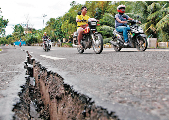
●宿霧省塔博貢鎮一條主要公路破裂。 法新社
