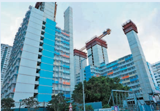
●屯門欣寶路簡約公屋發現部分連接混凝土核心牆的螺絲被剪短。 香港文匯報記者鄧偉明 攝
