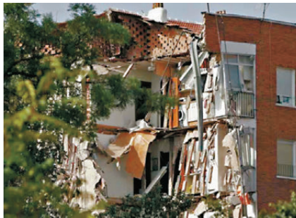
●馬德里一棟正在施工的建築倒塌。 網上圖片
