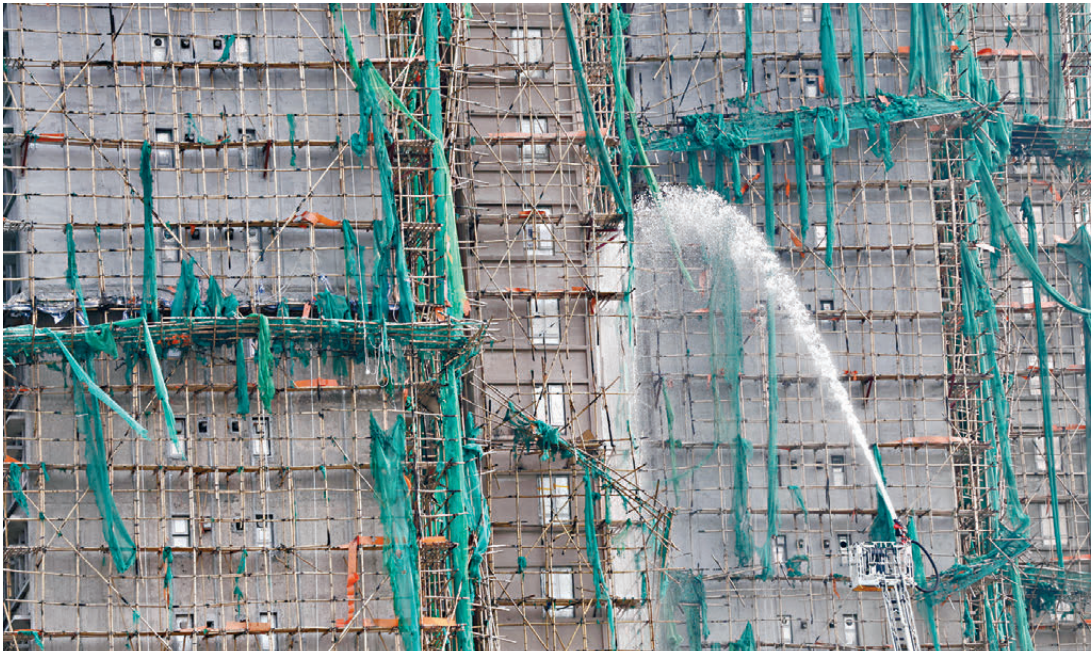
●大廈外牆棚架保護網、保護膜、防水帆布及塑膠布等，疑未符防火標準。
