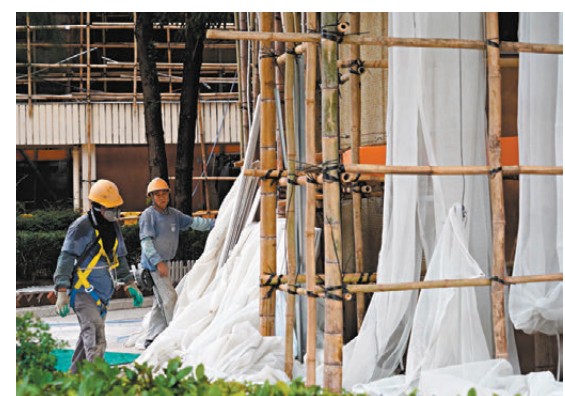
●宏福苑火災後，本港揭發多間建築商採取不合規物料，保聯預料建築全險保費將有很大機會調整。圖為工人早前拆除棚網。資料圖片
